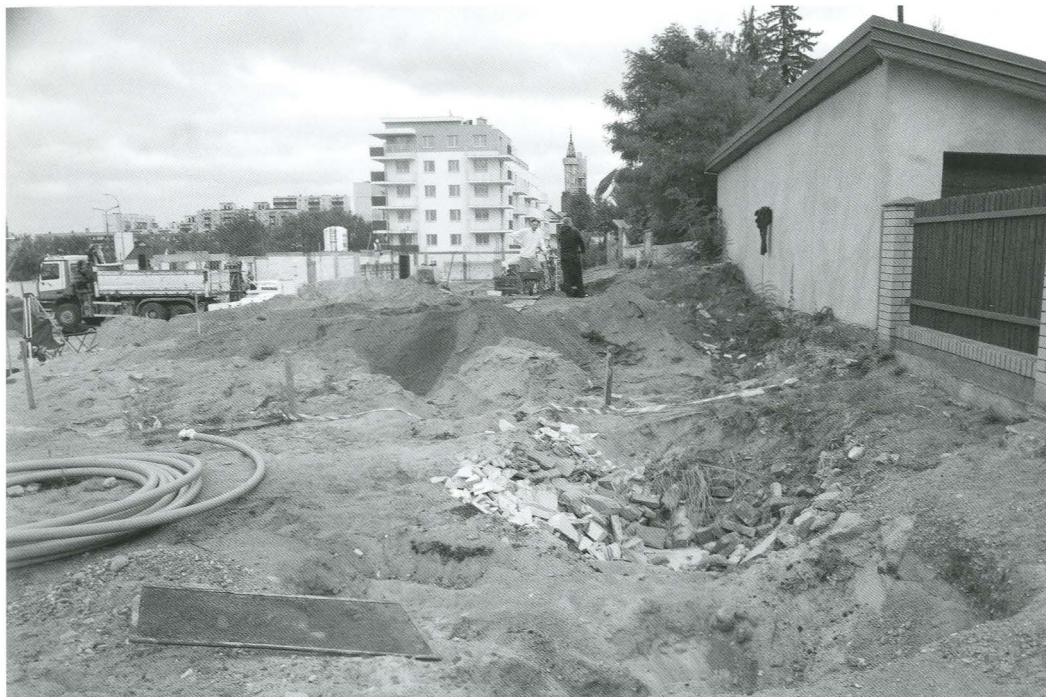
9. Białystok, stan. 50 – ul. Antoniuk Fabryczny 32. Południowa, zniszczona część stanowiska. Fot. L. Pawlata. Białystok, site 50 – 32 Antoniuk Fabryczny Street. Southern devastated part of the site. Photo: L. Pawlata.
