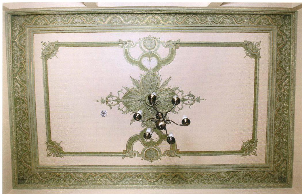
17. Dekoracja sztukatorska „łącnika” po konserwacji. Fot. K. Michałowski. Stucco decoration of the “skyway’ after conservation. Photo: K. Michałowski.
