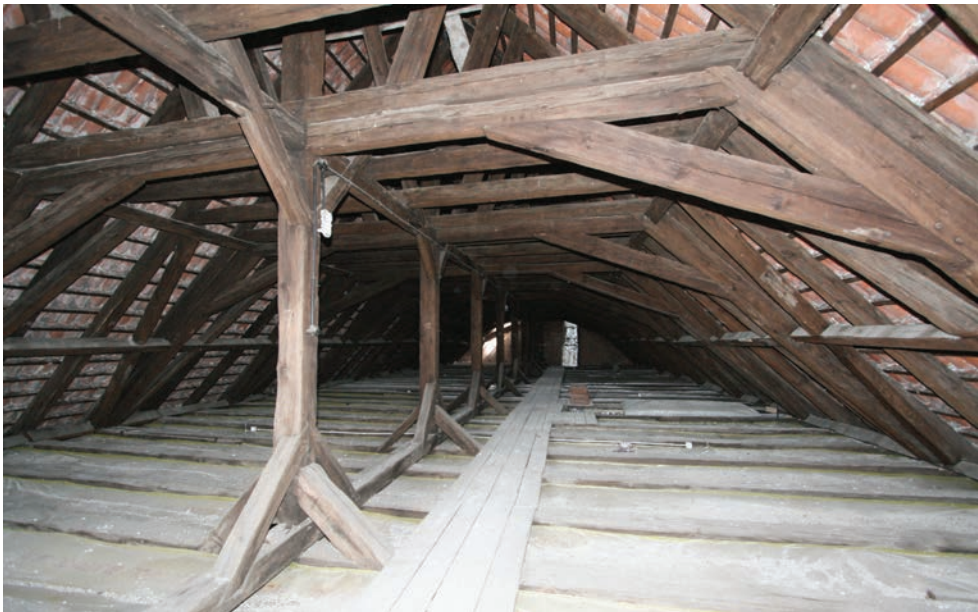
2. Widok ogólny więźby dachu nad nawą główną katedry w Łomży. Fot. M. Warchoń General view of the roof trusses over the nave of the cathedral in Łomża. Photo by M. Warchoń
