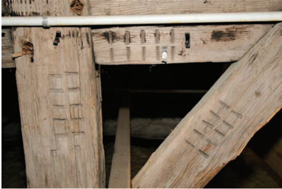
8. Ciesielskie oznaczenia montażowe na elementach wiązara więźby kościoła w Niedźwiadnej. Fot. M. Warchoł Carpentry installation marks on the elements of the truss of the church in Niedźwiadna. Photo by M. Warchoł
