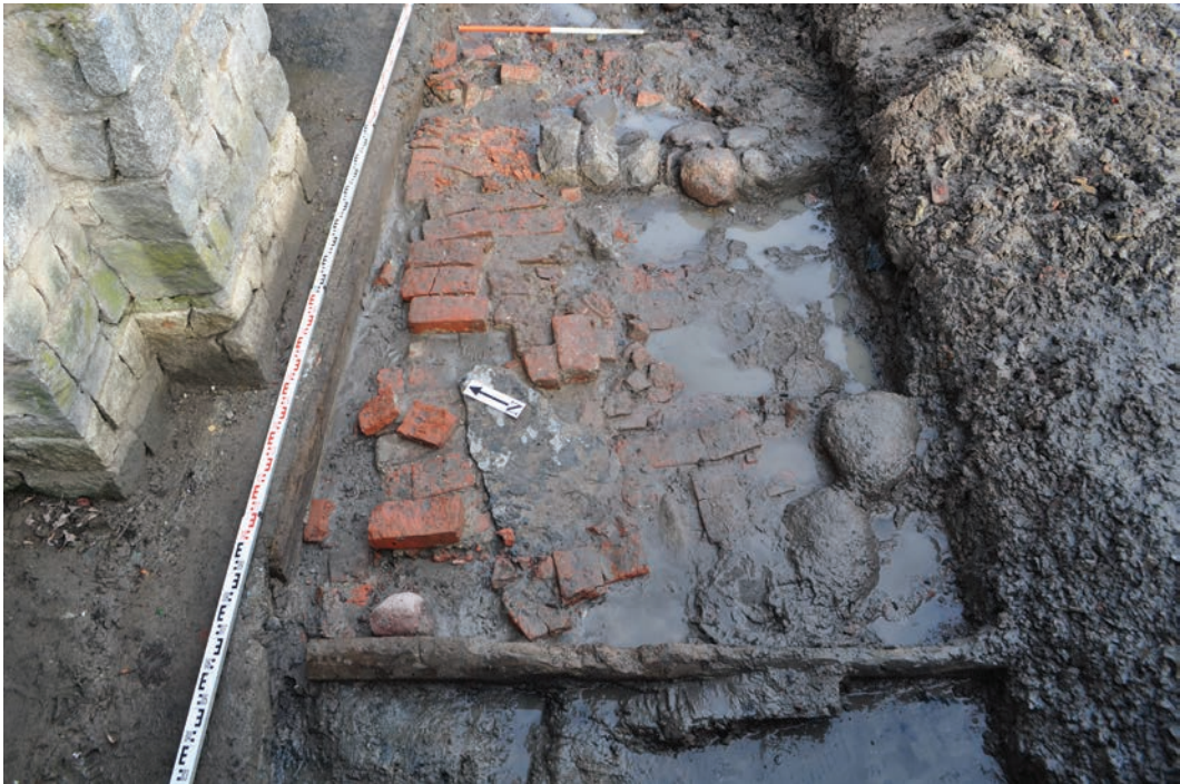
15. Białystok, stan. 1 - Ogród Branickich. Most na kanale. Relikty przyczółka zachodniego historycznego mostu oraz umocnienie brzegu przystani. Fot. M. Koziel Białystok, site 1 - The Branicki Garden. The canal bridge. Relics of the historic bridge's western abutment and marina coastline fortifications. Photo by M. Koziel
