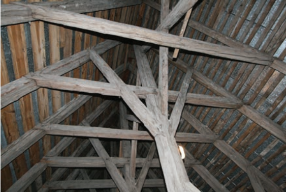
15. Widok więźby nad nawą główną kościoła w Szczepankowie. Fot. M. Warchoł View of rafter framing over the main nave of the church in Szczepankowo. Photo by M. Warchoł
