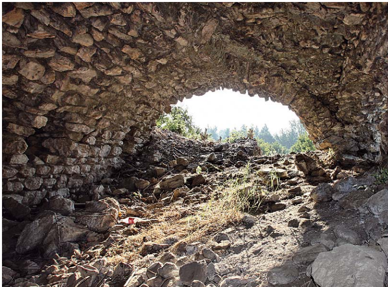
1 Kammer 1 vor partiellem Einsturz im Januar 2010
