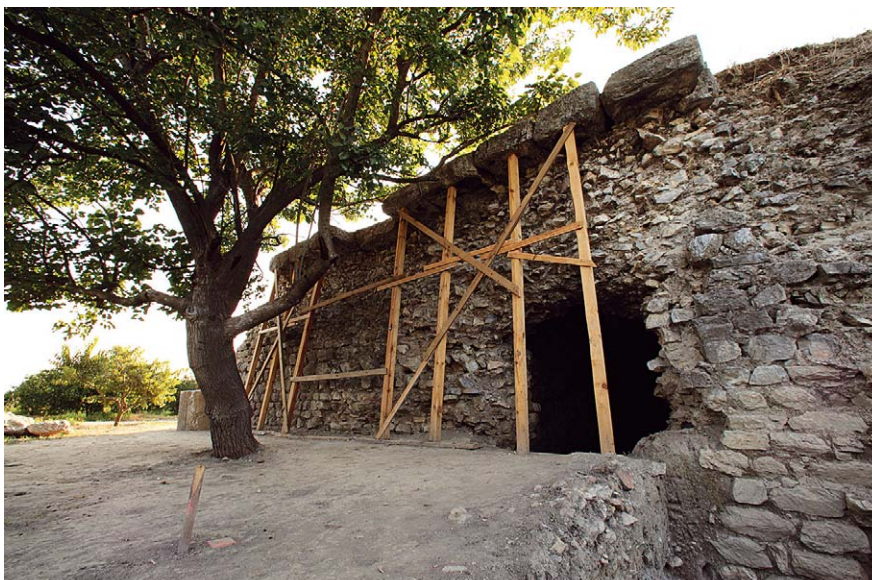
3 Provisorische Sicherung des Gurtgesimses an der Westfassade
