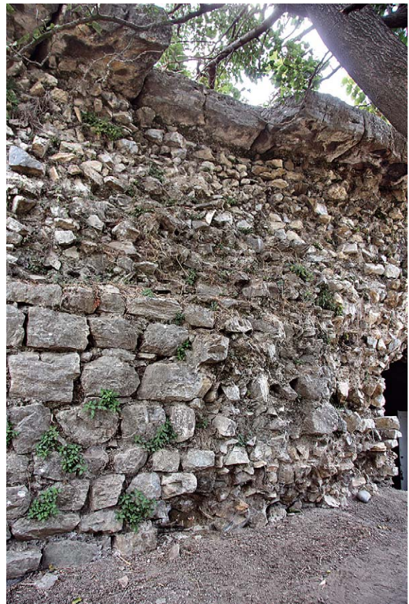
3 Westfassade: Rücksprung des Gurtgesims im Bereich des ausgerissenen Pilasters
